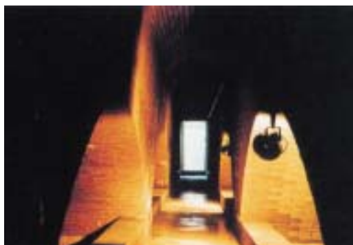
赤レンガを使用した平原低区配水池内部 （大正7年3月完成）
