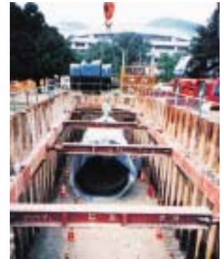
飲料水兼用耐震性貯水槽設置状況(中央公園内)
